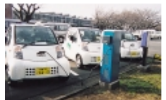
電気自動車駐車・充電設備
