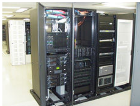
導入した省エネ型サーバー(いすゞ本社)
