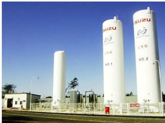
液化天然ガス(LNG)プラント
