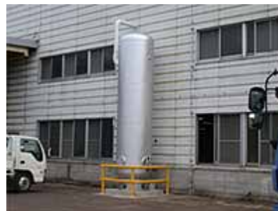
エア配管末端のレシーバータンク
