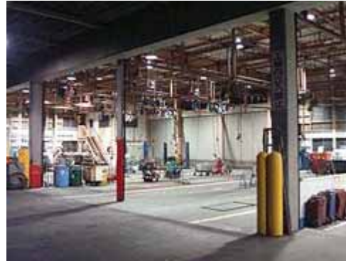
サービス工場照明ランプの変更 (水銀ランプ セラミックメタルハライドランプ+ 配光可変形デード)
