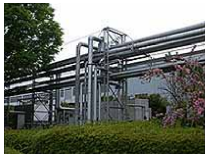
エアのループ配管
